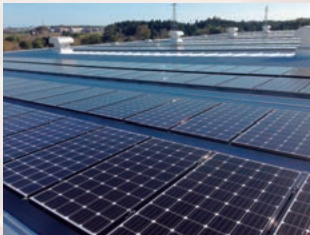
太陽光発電システムの施工例（茨城工場）
