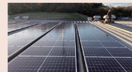
太陽光発電パネル(神戸工場)
