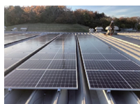
太陽光発電システム
