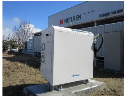
EV充電スタンド
