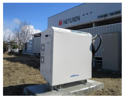
EV充電スタンド
