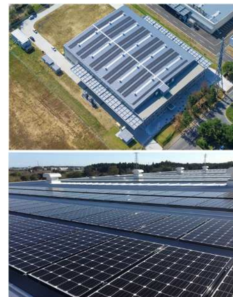
茨城工場 太陽光発電システム
