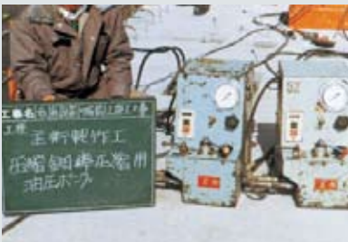
圧縮PC鋼材用油圧ポンプ
